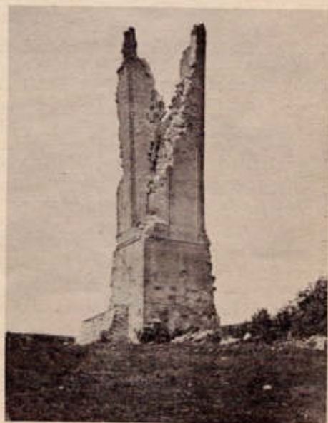
Turm der Klosterruine Burghausen (Hessen) durch den Blitz gespalten am 1. Juli 1876
